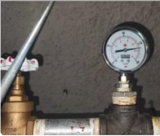
Central de monitoreo casas 160 psi
