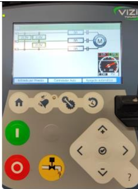
Presión equipo contra incendios 150 psi
