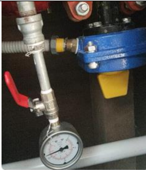
Lectura manómetros estación de control degress sur piso 1 / 160 psi manómetro de 0 a 200 psi
