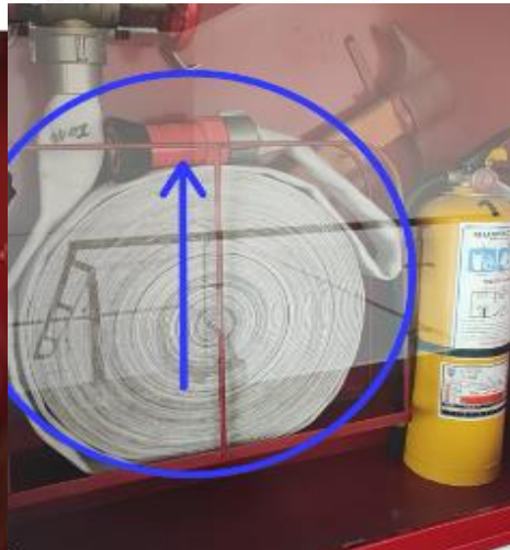
Elementos gabinetes # 1 se reporta para cambio manguera de 1 1/2" chaqueta sencilla x 30 metros largo x 150 psi UL/FM adaptadores en bronce , adicional se reporta para cambio boquilla chorro niebla de 1 1/2" UL/FM x 150 psi presentan fugas
