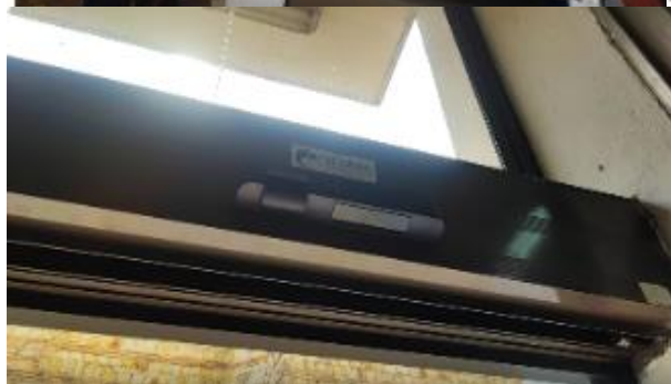
Control de Acceso Verticales pisos 10, 9, 8
