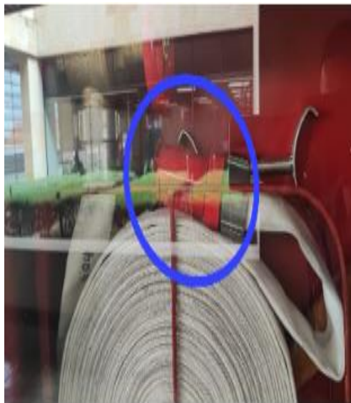
Elementos gabinetes, se reporta para cambio boquilla chorro niebla de 1 1/2" en bronce x 150 psi UL/FM por fugas # gabinete 4
