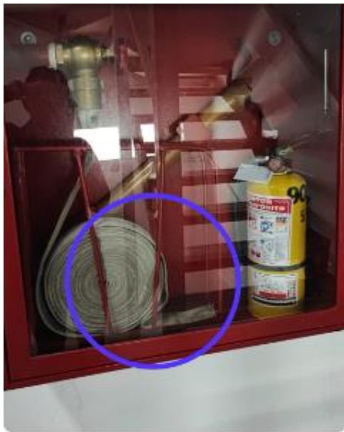
Item elementos gabinetes manguera contra incendios se reporta para cambio daño acople boquilla chorro piso 9
