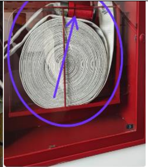
Elementos elementos gabinetes #3 se reporta para cambio manguera de 1 1/2" x 30 metros x 150 psi chaqueta sencilla adaptadores hembra en bronce UL/FM, adicional cambio de boquilla chorro niebla de 1 1/2" en bronce x 150 psi UL/FM (fugas en ambos elementos)
