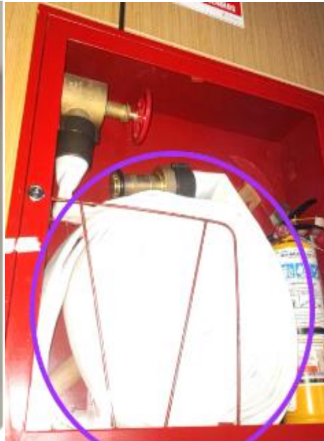
Revisión de elementos, manguera para cambio de 2 1/2" x 30 metros a 250 psi chaqueta sencilla adaptadores en bronce # gabinete 22 auditorio
