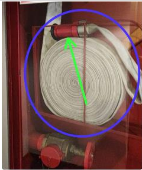
Elementos gabinetes se reporta cambio de manguera de 1 1/2" x 150 psi chaqueta sencilla x 30 metros adaptadores hembra en bronce, adicional de reporta cambio de boquilla chorro niebla para cambio en bronce de 1 1/2" x 150 psi UL/FM (fugas en ambos elementos) gabinete #10
