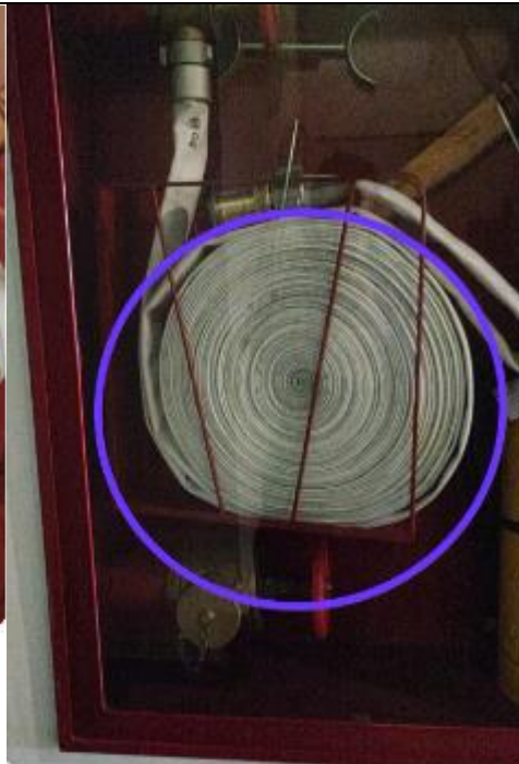
Elementos gabinete #6 se reporta para cambiar la manguera de gabinete de 1 1/2" x 30 metros chaqueta sencilla x 150 psi adaptadores en bronce UL/FM
