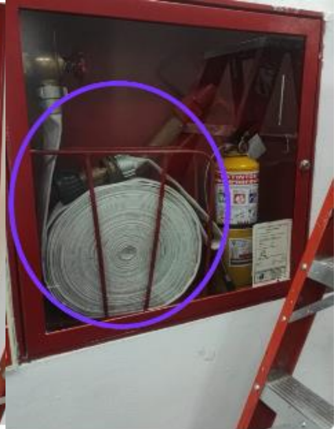
Elementos gabinetes manguera se reporta nuevamente para cambio fuga en chaqueta gabinete piso 4
