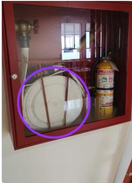
Elementos gabinetes del piso 7 manguera se reporta nuevamente para cambio presenta fugas en chaqueta
