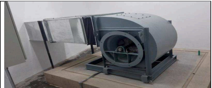
VEC - 3 Con Tablero TAA4
