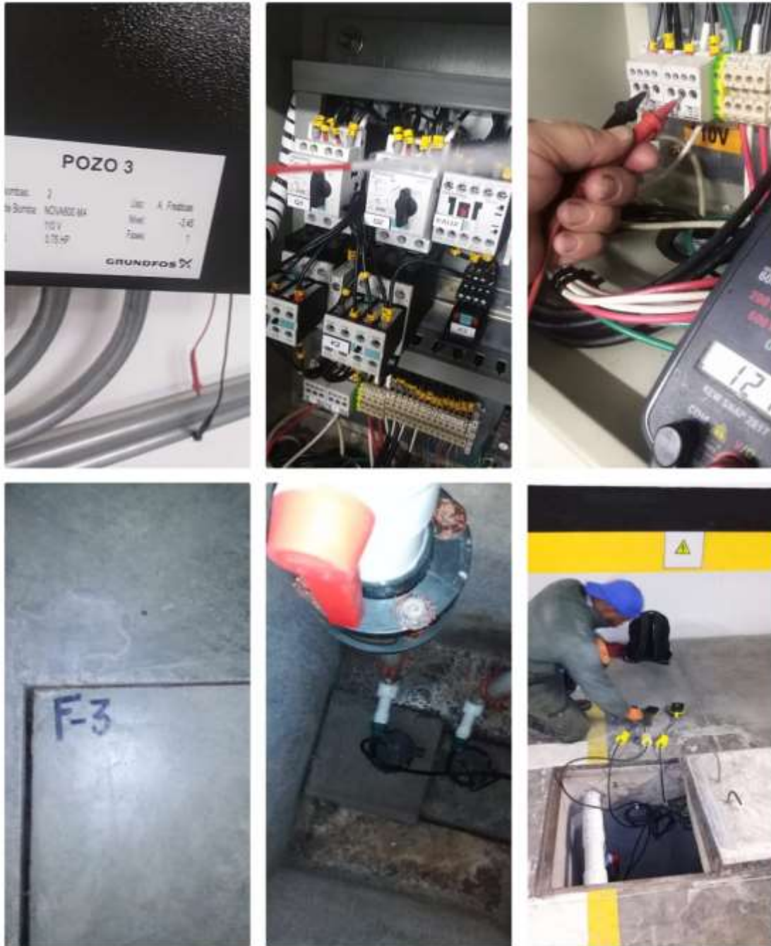
FIGURA 7 POZO 3 EQUIPO NIVEL FREATICO
