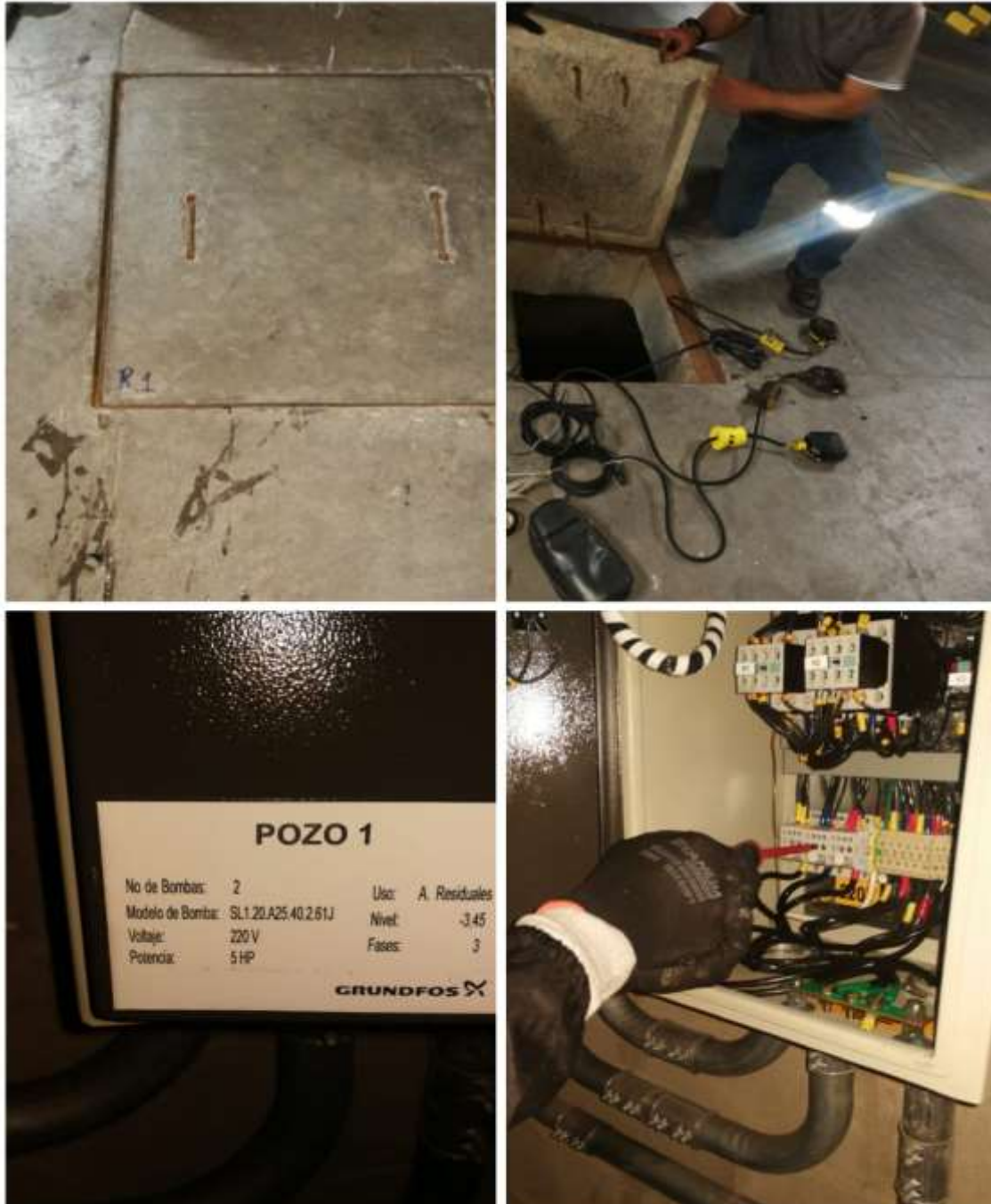
FIGURA 4 POZO 1 EQUIPO DE AGUAS RESIDUALES
