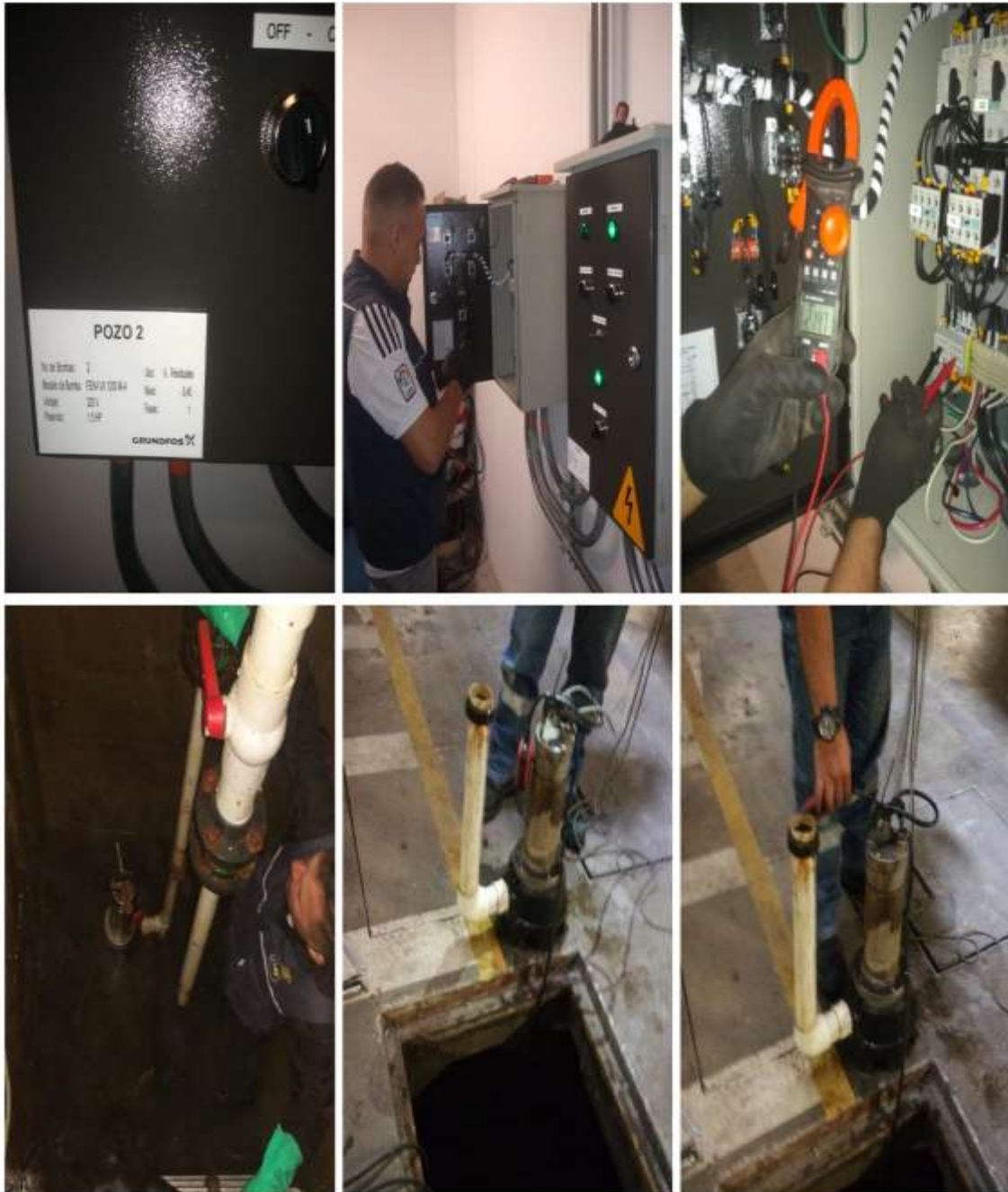
FIGURA 5 POZO 2 EQUIPO DE AGUAS RESIDUALES
