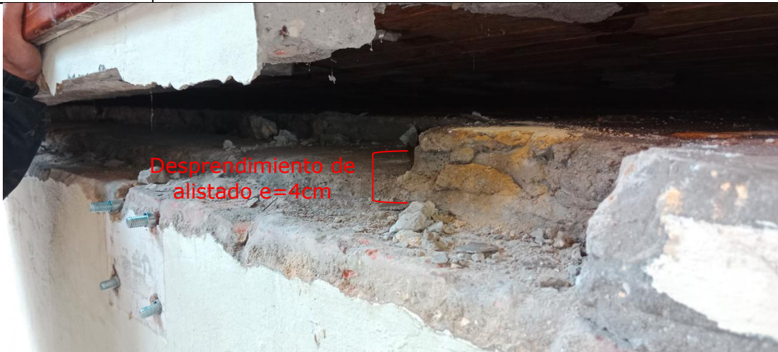
Fotografía 7. Desprendimiento alistado, contacto muro-placa-alistado.
