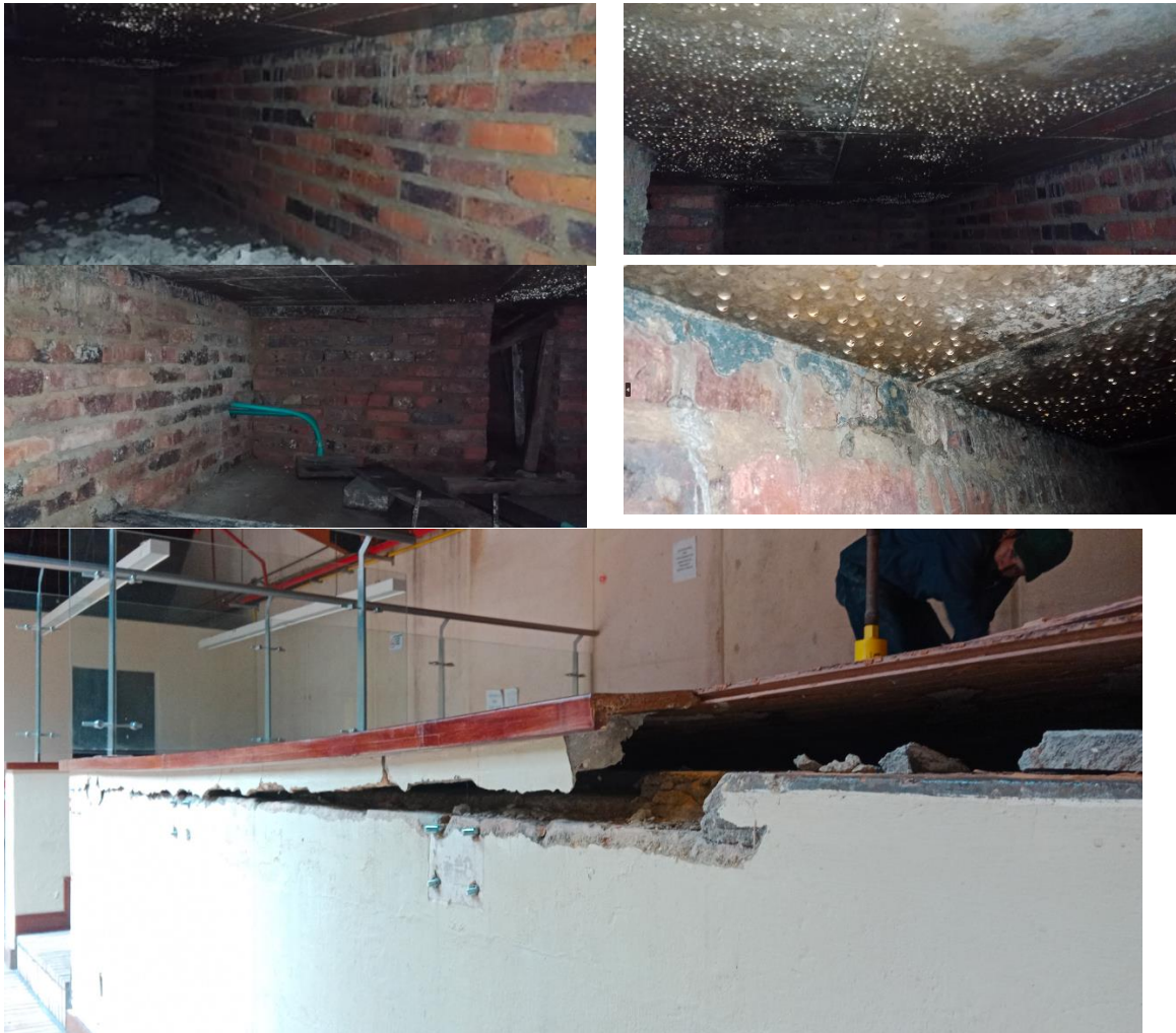
Fotografía 5. Exploración Tarima casa 4, no grietas ni fisuras, presenta exudación.
