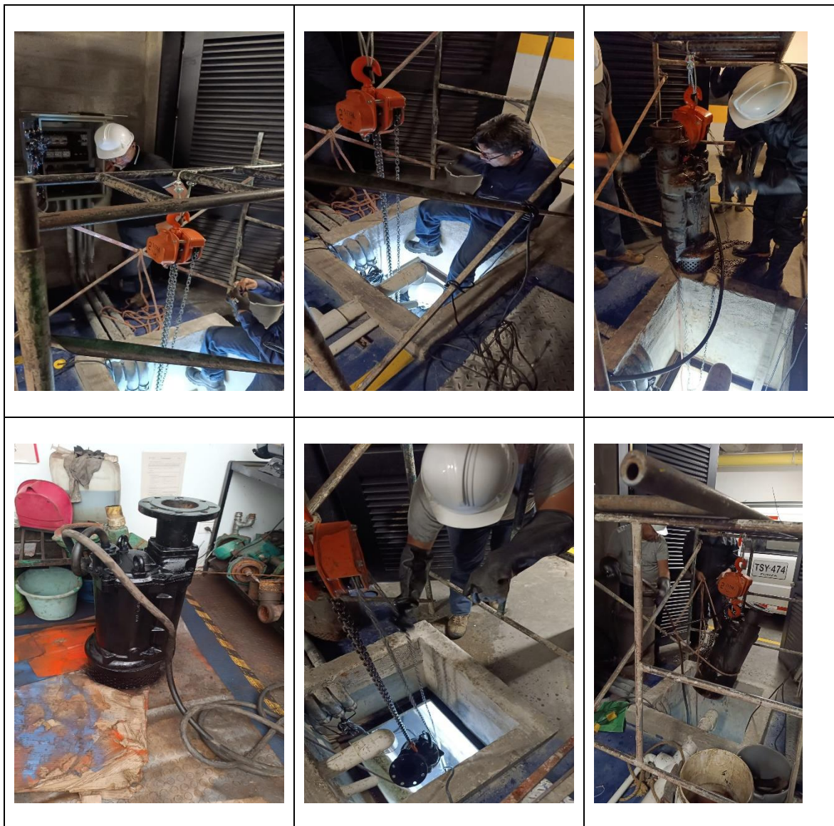
FIGURA 2 EQUIPÓ DE AGUAS LLUVIAS
