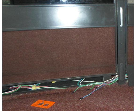
Instalación y reorganización de circuitos y tomas eléctricas de puestos de trabajo
