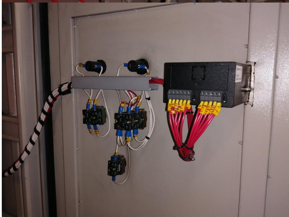
Imagen 6. Limpieza de las transferencias de 500KVA
