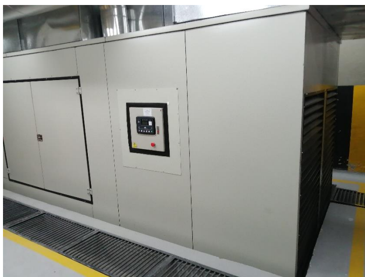
Imagen 1. Planta Eléctrica PERKINS de 1200 KVA
