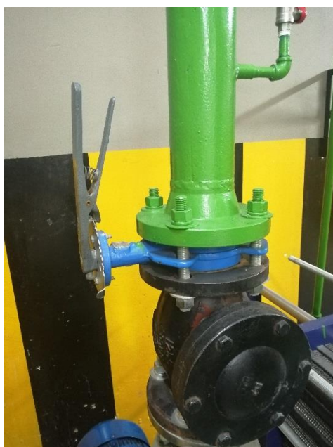
Imagen 12. Válvula del sistema hidráulico
