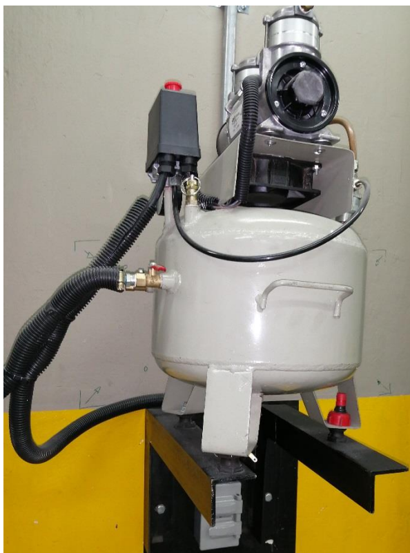
• Imagen 10. Tanque de presión sistema de ventilación
