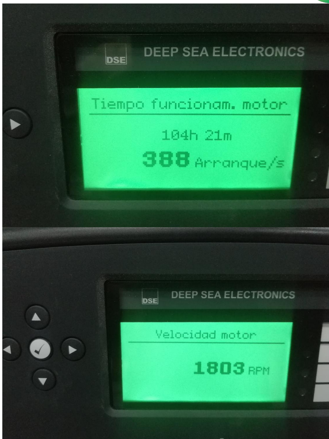
Imagen 2. Planta eléctrica en modo manual.
