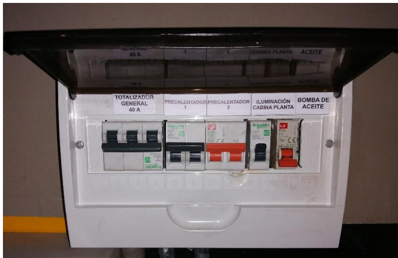
Imagen 5. Breakers del sistema electrógeno
