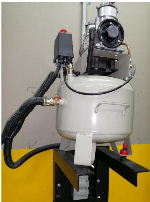
Imagen 9. Tanque de presión sistema de ventilación
