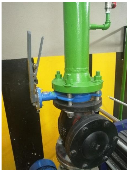
Imagen 11. Válvula del sistema hidráulico
