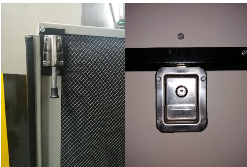
Imagen 10. Seguros y chapas de seguridad gastados
