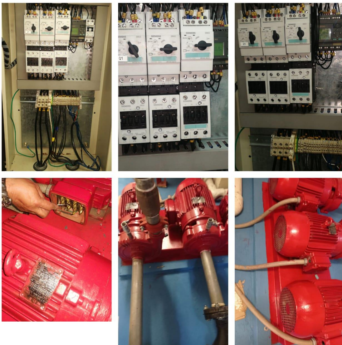
Figura 1 Equipo de presión agua potable
