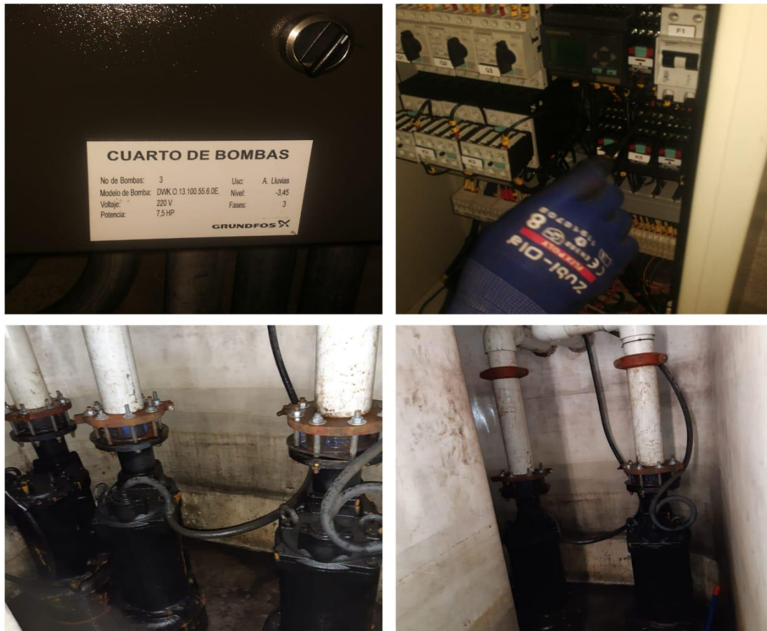
FIGURA 2 EQUIPÓ DE AGUAS LLUVIAS
