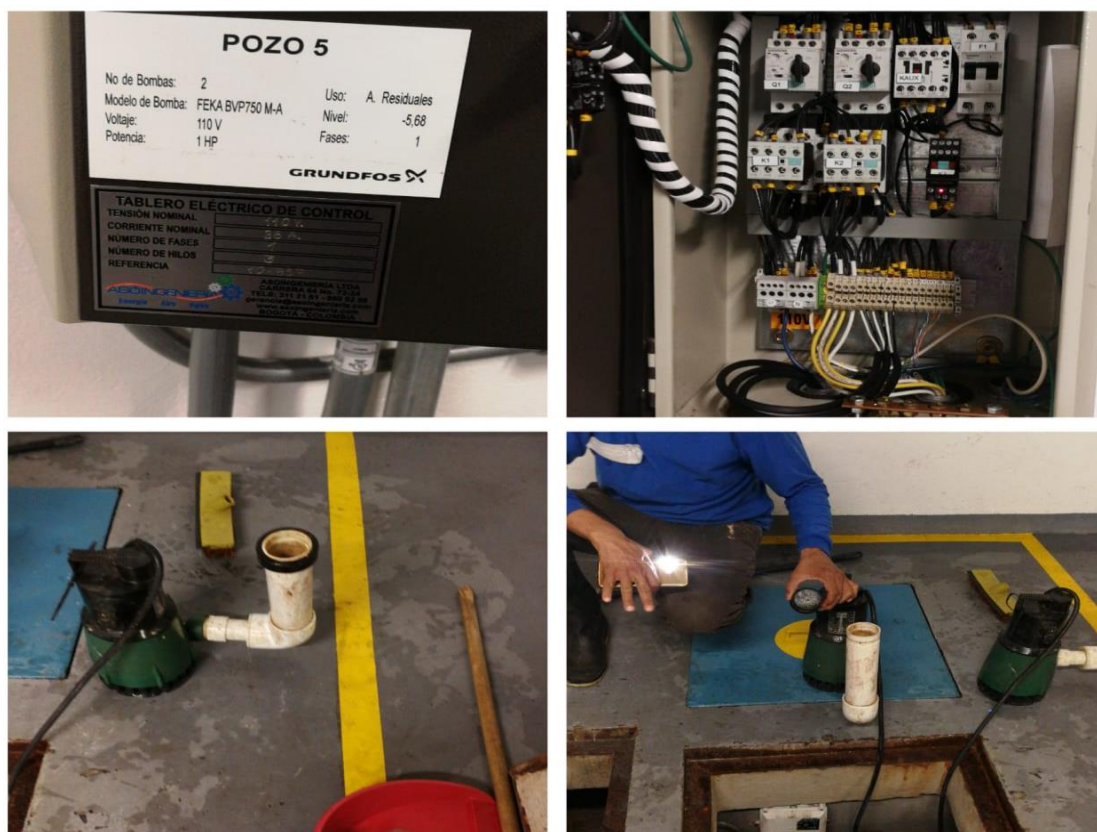
FIGURA 9 POZO 5 EQUIPO DE NIVEL FREÁTICO
