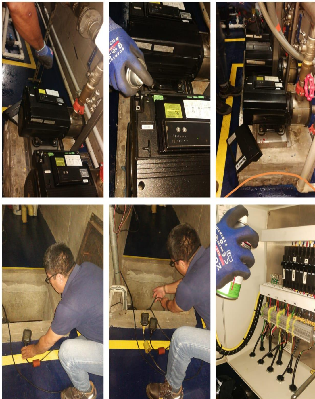
Figura 1 Equipo de presión agua potable
