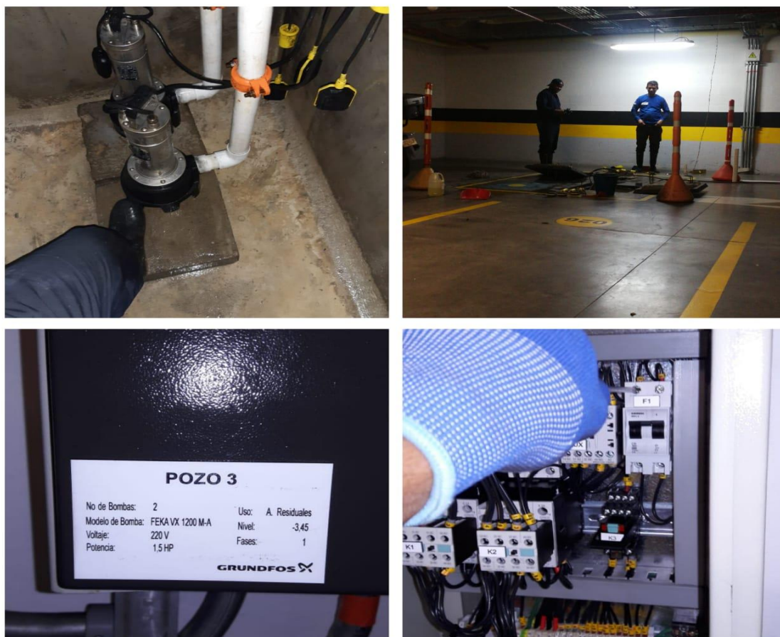
FIGURA 6 POZO 3 EQUIPO DE AGUAS RESIDUALES
