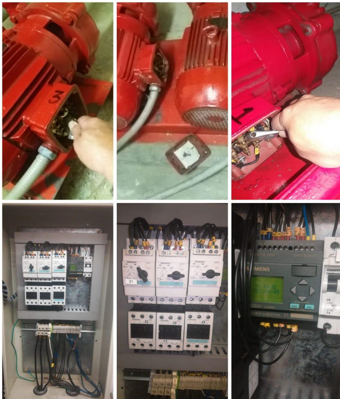
Figura 1 Equipo de presión agua potable
