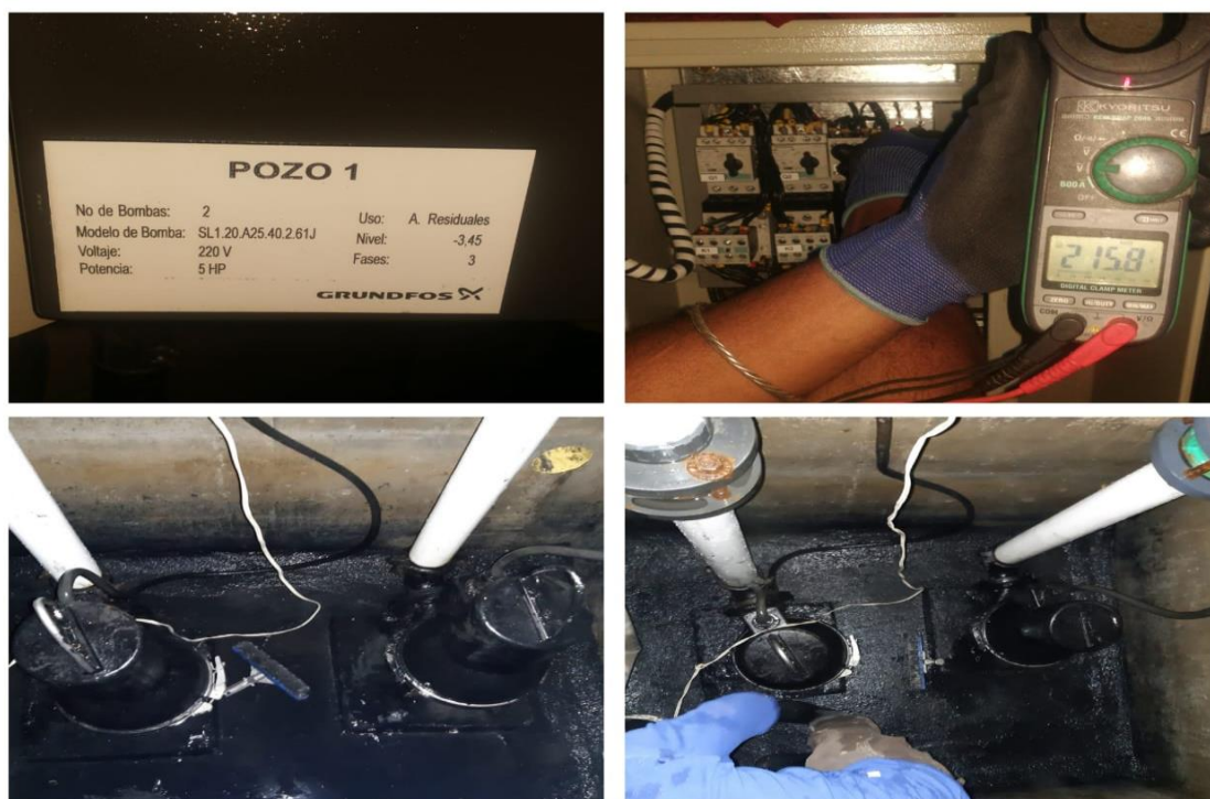
FIGURA 4 POZO 1 EQUIPO DE AGUAS RESIDUALES
