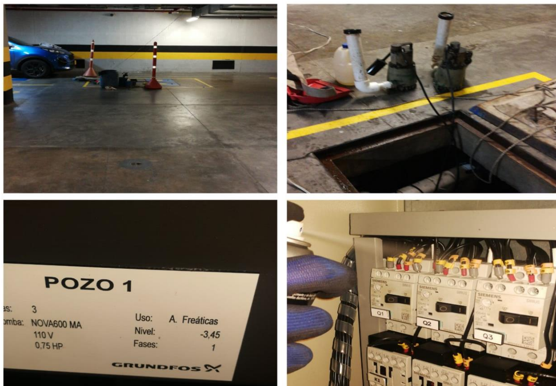
FIGURA 3 POZO 1 EQUIPO DE NIVEL FREÁTICO.
