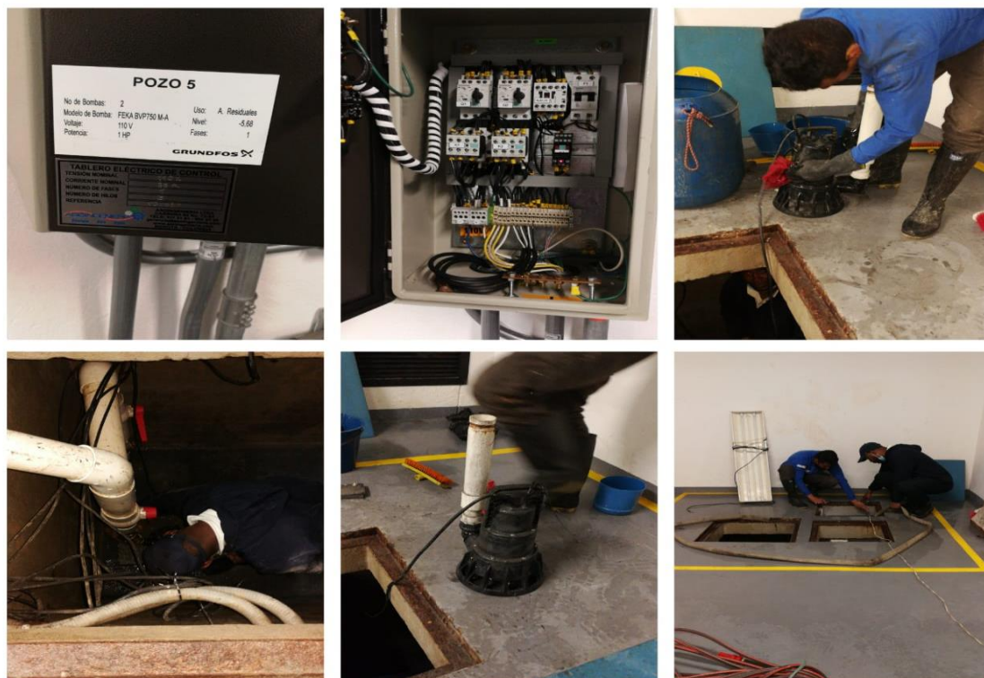
FIGURA 10 POZO 5 EQUIPO DE AGUAS RESIDUALES
