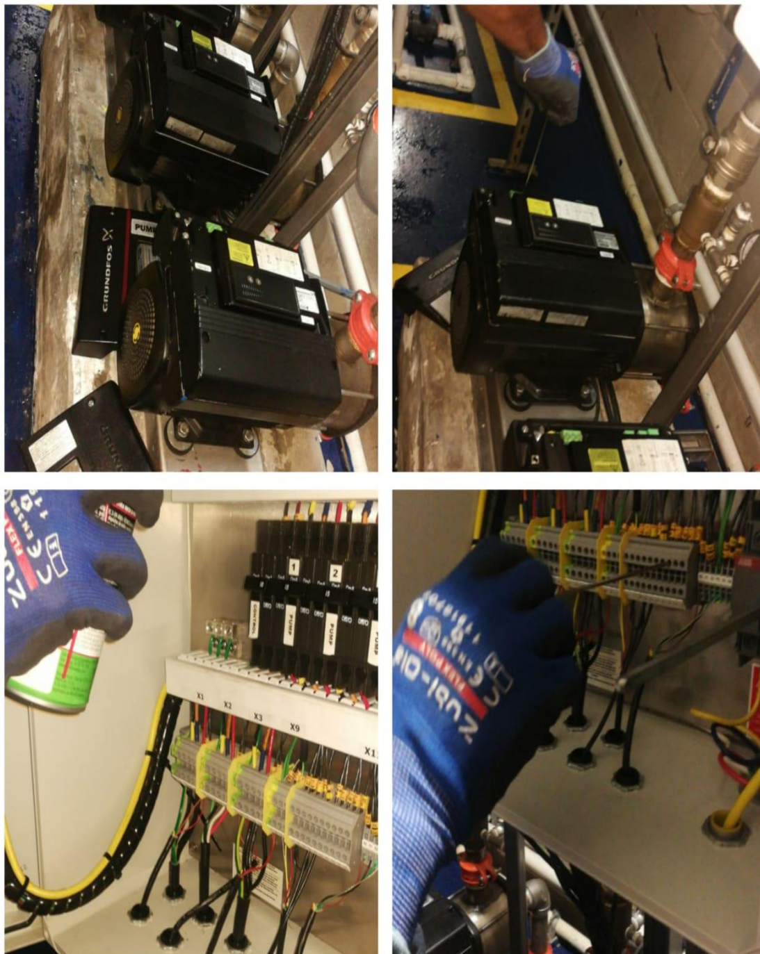
Figura 1 Equipo de presión agua potable
