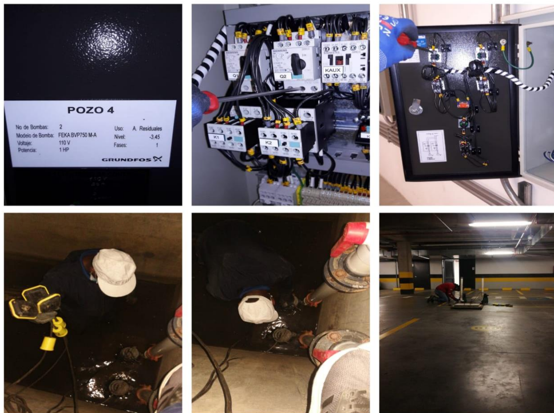
FIGURA 8 POZO 4 EQUIPO DE AGUAS RESIDUALES
