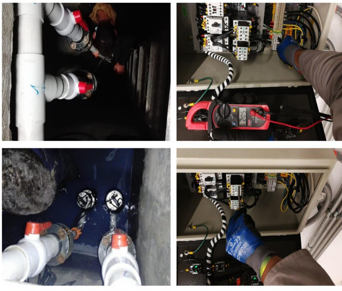
FIGURA 6 POZO 3 EQUIPO DE AGUAS RESIDUALES
