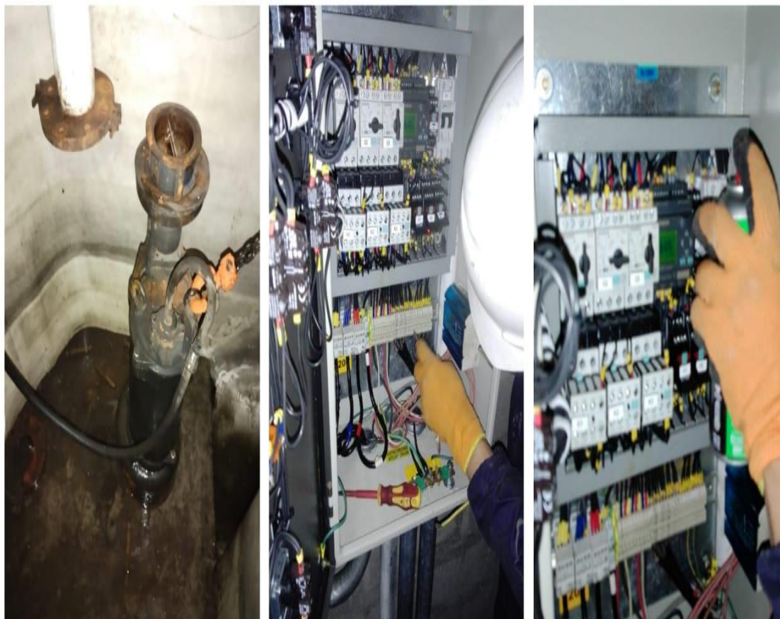
FIGURA 2 EQUIPÓ DE AGUAS LLUVIAS
