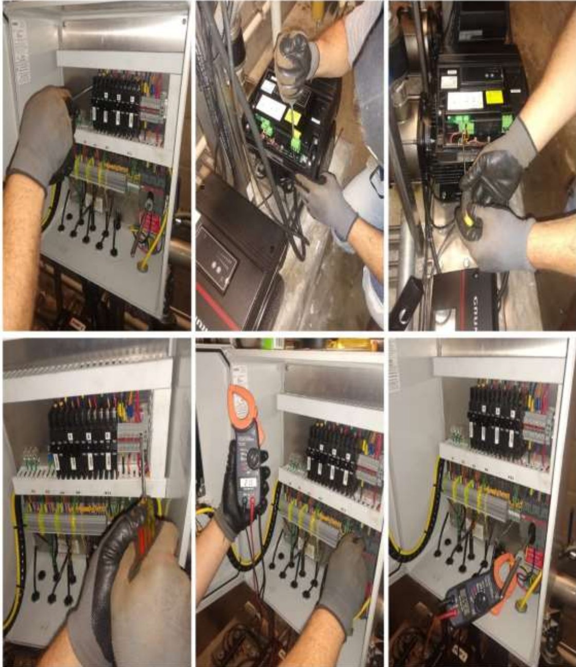
Figura 1 Equipo de presión agua potable
