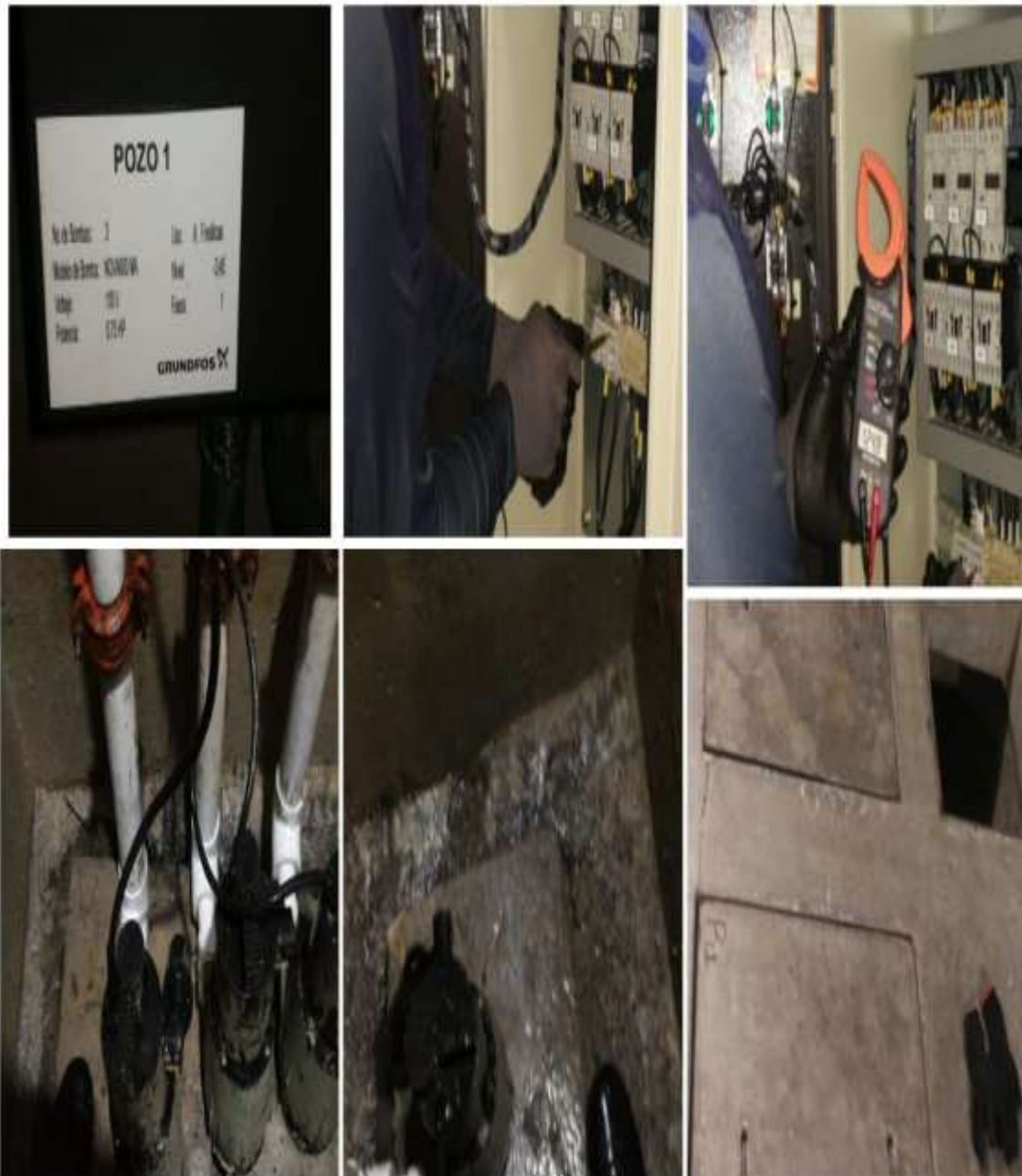
FIGURA 3 POZO 1 EQUIPO DE NIVEL FREÁTICO.
