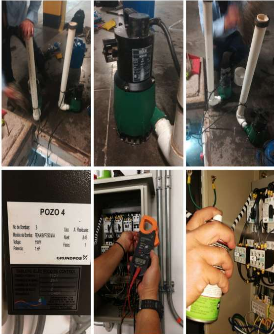
FIGURA 8 POZO 4 EQUIPO DE AGUAS RESIDUALES
