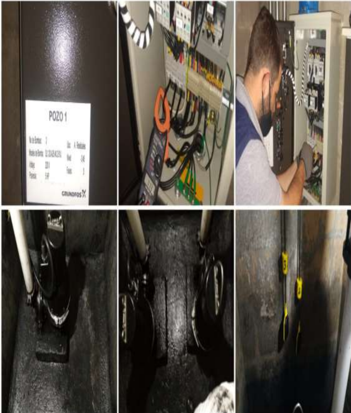
FIGURA 4 POZO 1 EQUIPO DE AGUAS RESIDUALES
