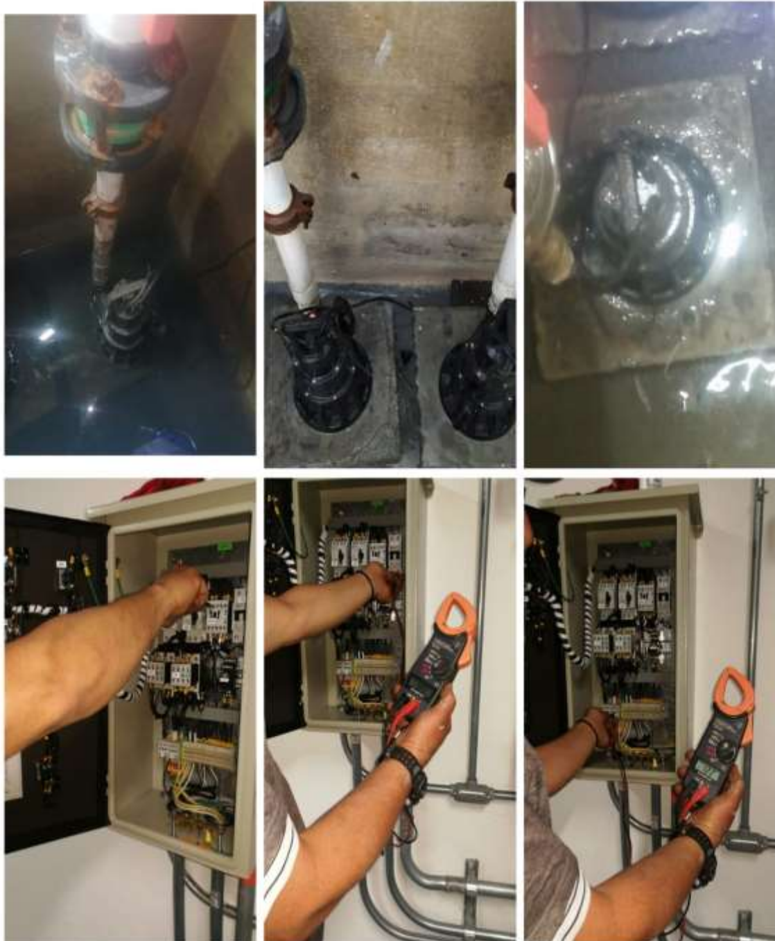
FIGURA 10 POZO 5 EQUIPO DE AGUAS RESIDUALES
