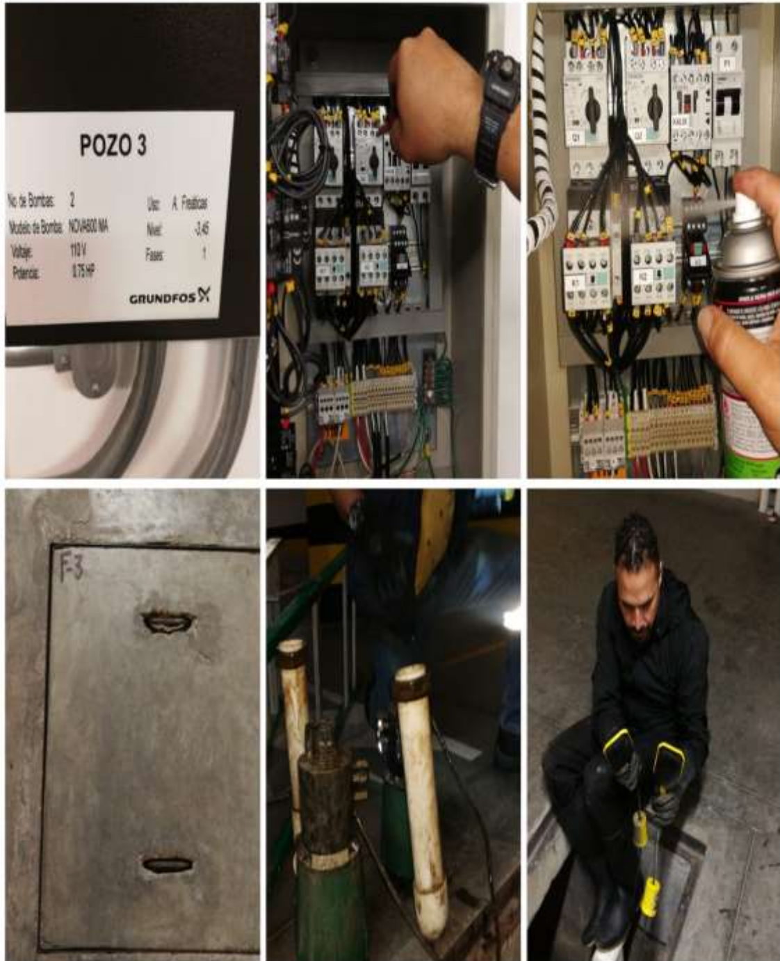
FIGURA 7 POZO 3 EQUIPO NIVEL FREÁTICO
