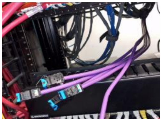
Ponchado en rack de comunicaciones
