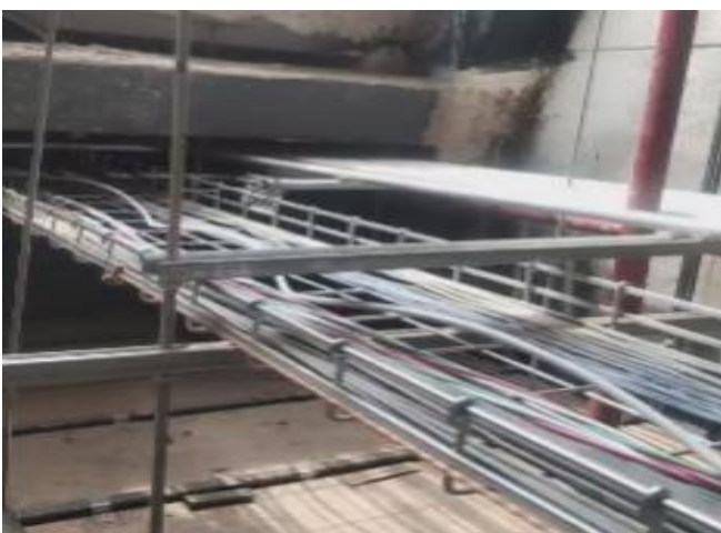
Tendido horizontal en bandeja portacable
