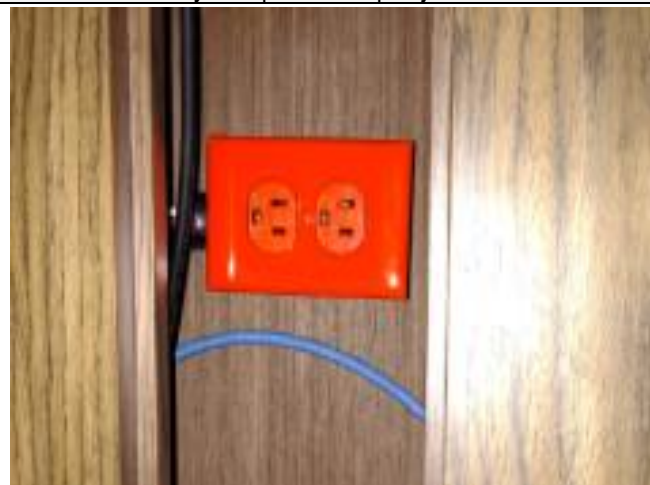
Instalación de toma regulada en mesa
