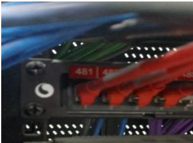
Intercambio de jacks en patch panel
