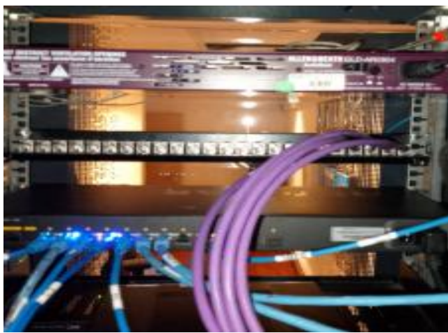
Ponchado y peinado en patch panel
