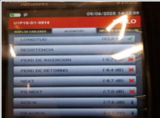
Comprobación parámetros U1P1S-D1-0514 FALLA
