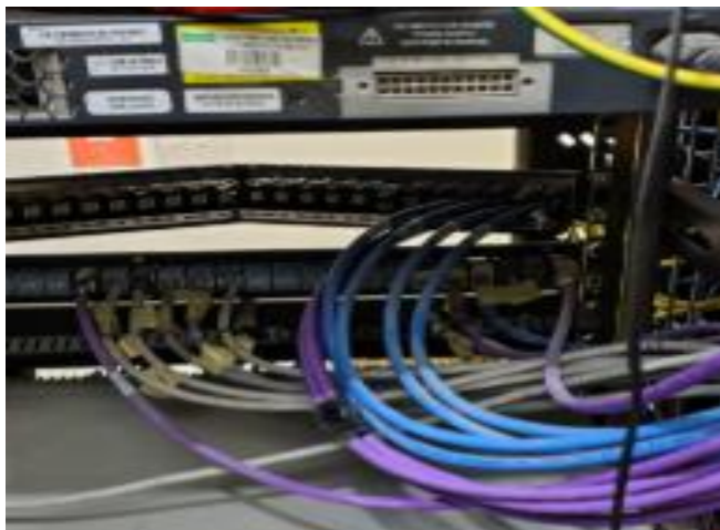
Ponchado y marquillado en patch panel
