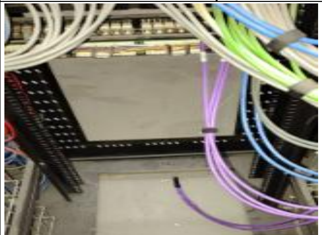
Ponchado y marquillado en patch panel
