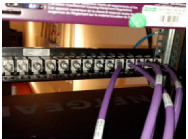
Ponchado y marquillado en patch panel
