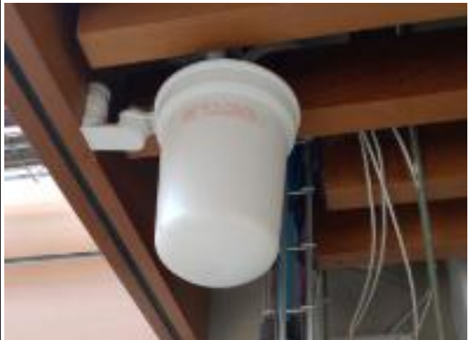
Identificación y ubicación de equipos
