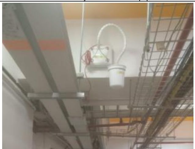
Identificación y ubicación de equipos
