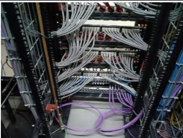
Ponchado y marquillado en patch panel
