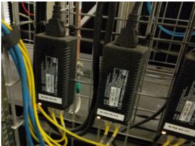
Identificación y ubicación de componentes eléctricos
