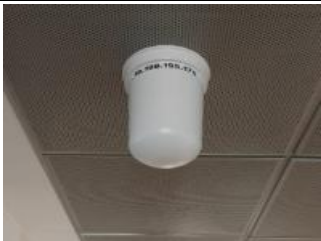
Identificación y ubicación de equipos
