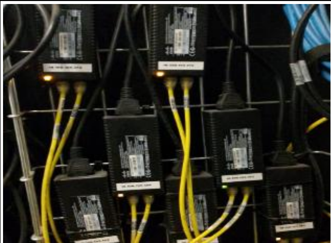
Identificación y ubicación de componentes eléctricos
