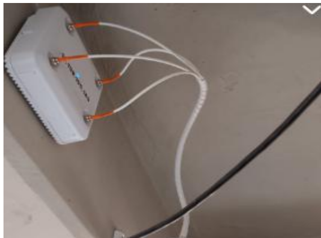
Identificación y ubicación de equipos
