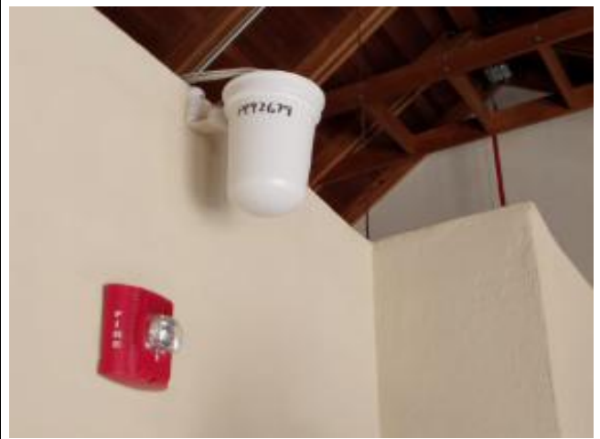
Identificación y ubicación de equipos
