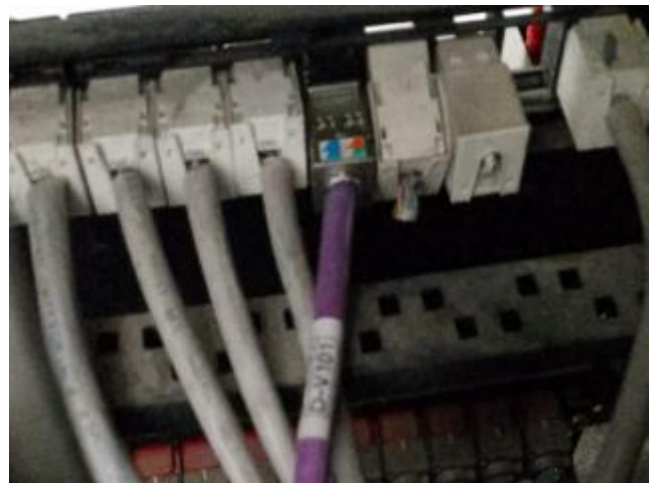
Ponchado y marquillado en patch panel
