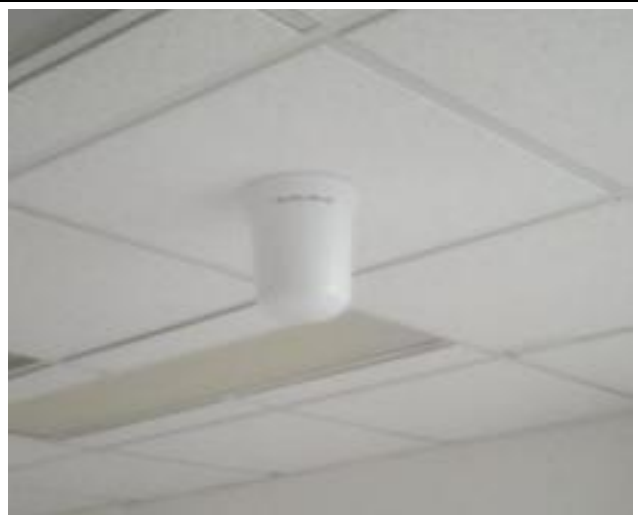
Identificación y ubicación de equipos
