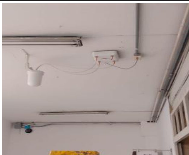
Identificación y ubicación de equipos
