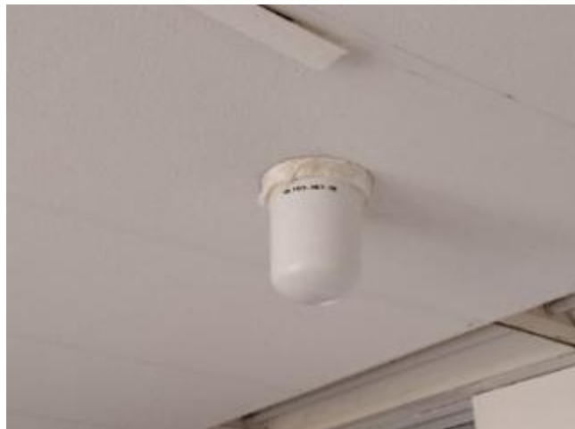
Identificación y ubicación de equipos
