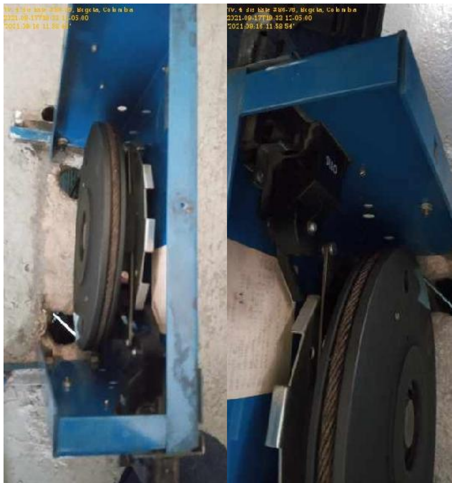
Limitador de Velocidad - Después
