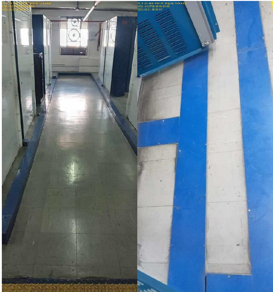
Cuarto de Maquinas - Después
