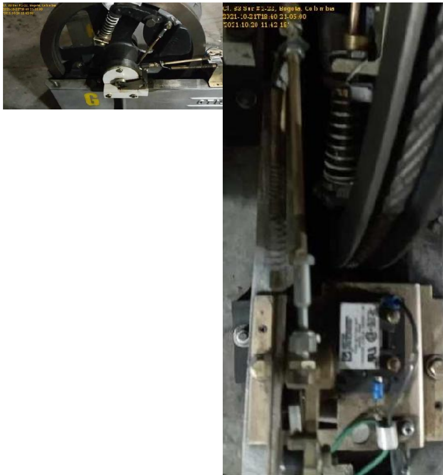
Limitador de Velocidad - Después
