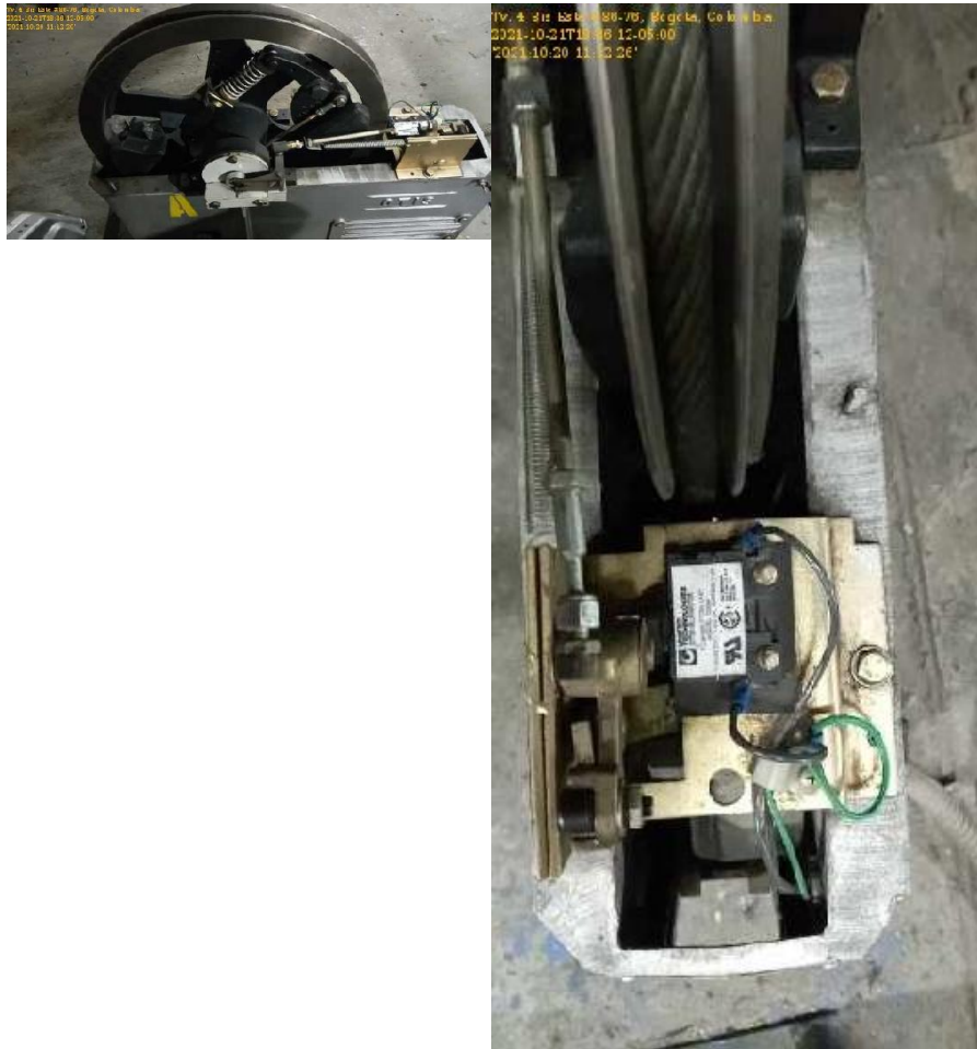
Limitador de Velocidad - Después
