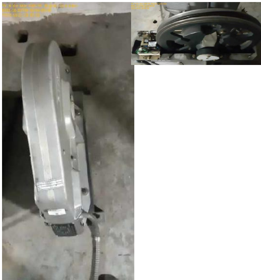
Limitador de Velocidad - Después
