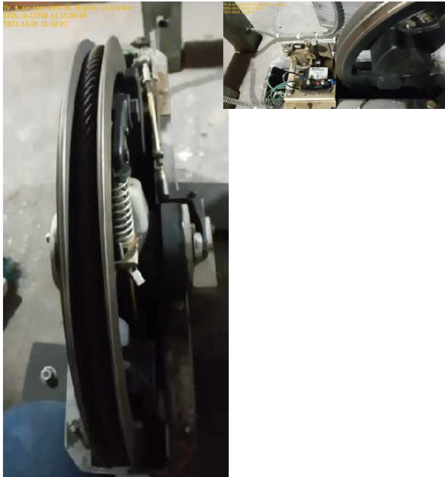
Limitador de Velocidad - Después
