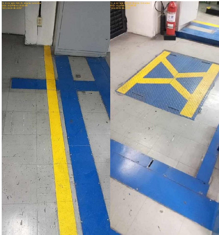
Cuarto de Maquinas - Después
