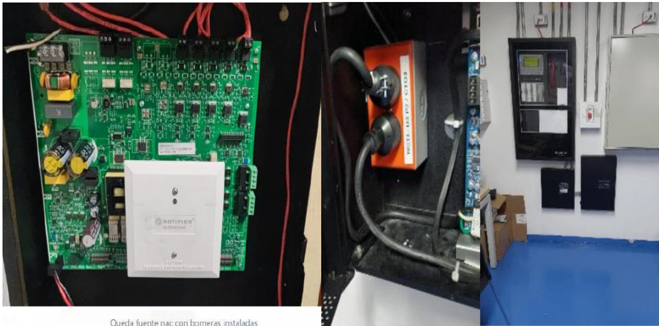
Queda fuente nac con borneras instaladas
