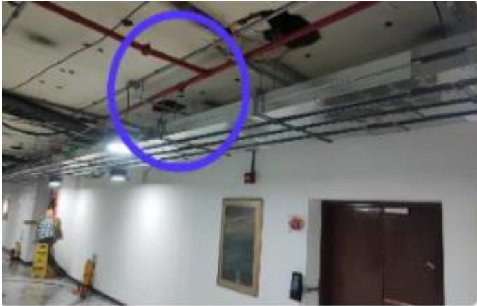
Red contra incendios 30 cm sobre nivel electrobarras sótano frente a archivo general
