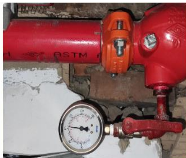
Sótano se realiza presurización red contra incendios 155 psi
