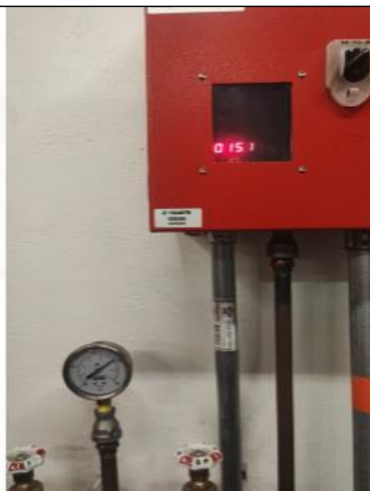
Manómetro 145 psi tablero 151 bomba jockey
