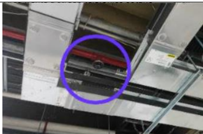
Punto rci sobre electrobarras frente a planta eléctrica DIAN
