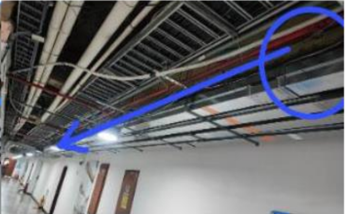
4 rociadores a 15 cm sobre electrobarras frente a la planta eléctrica mhcp
