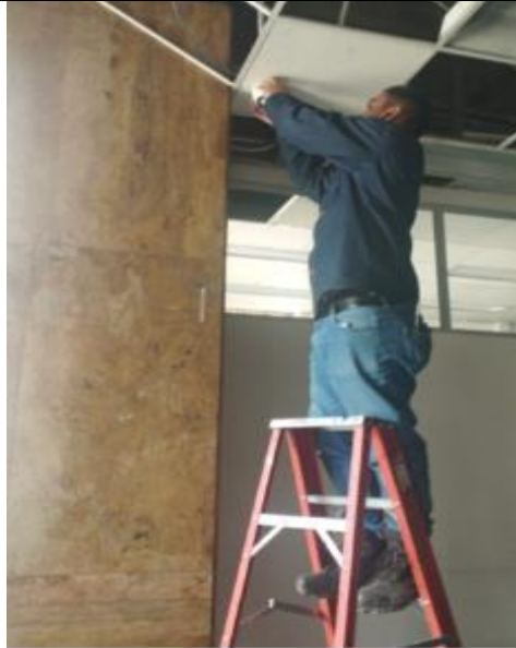
Se procede a desmontar las cámaras piso 1 que están en el techo
