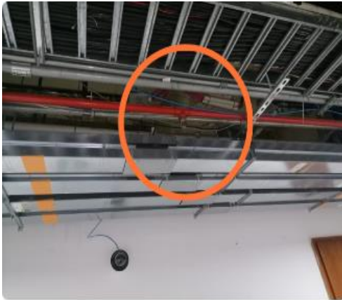
Se requiere reestructuración sistema RCI Sotano general S.A tipo montante
