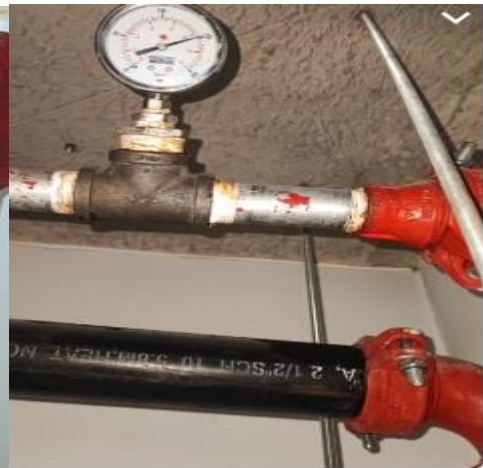
Cuarto operadores U3P3N 150 psi
