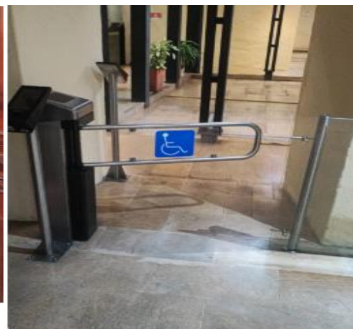
Liberación control de acceso con sistema de detección
