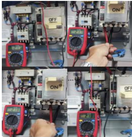
Medición de parámetros eléctricos de entrada y salida tablero de energía para bomba jockey san Agustín
