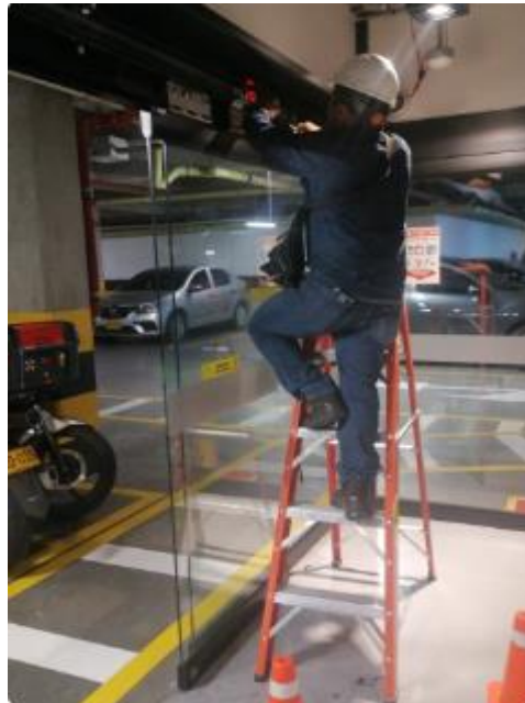
S3 U1 revisión de puerta automática ascensores
