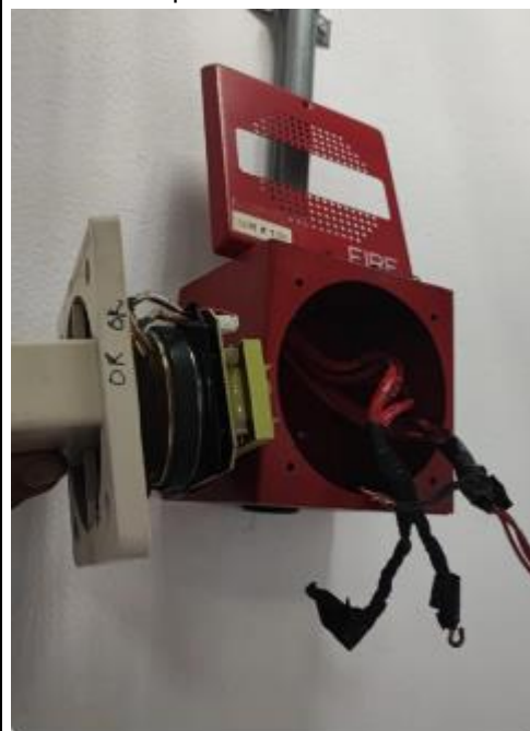
Se realiza cambio de sirena Hall
