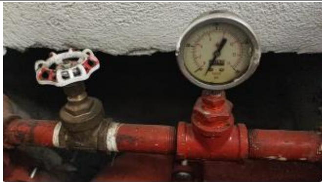
Manómetro Estación de control U2S2N se requiere cambio
