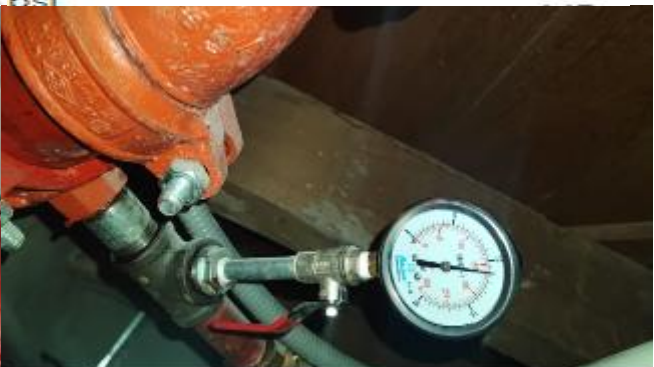
CASA1 DEGRESS COSTADO NORTE 160 PSI
