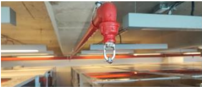
Rompimiento del Cristal del bulbo
