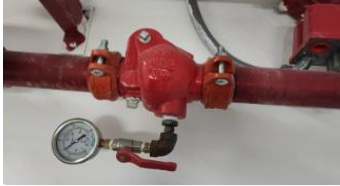
Lectura estaciones de control sede San Agustín piso 9 105 psi
