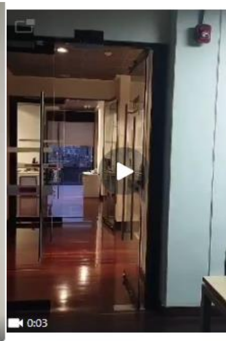
Unidad1 Piso2 estrobos y audio y puerta desbloqueada
