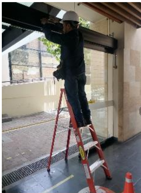
Revisión de puerta automática entrada cra 7
