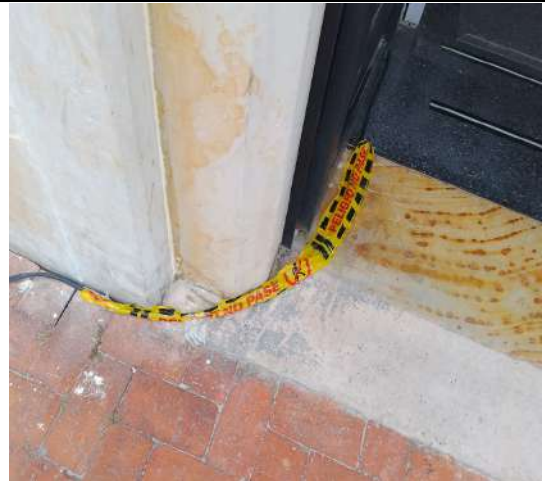
Señalización en pasillos
